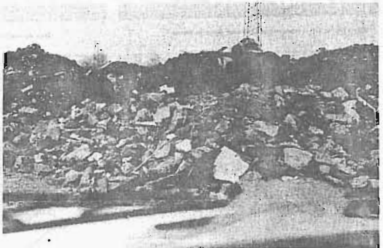
Des blocs de béton et des centaines de tonnes d'orge. Une odeur difficile à supporter pour les pêcheurs du voisinage, mais surtout une menace sérieuse pour la nappe phréatique.
